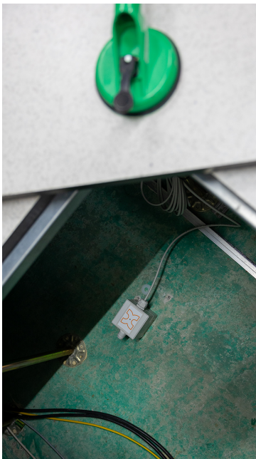
Kentix Leckagesensor im Doppelboden
