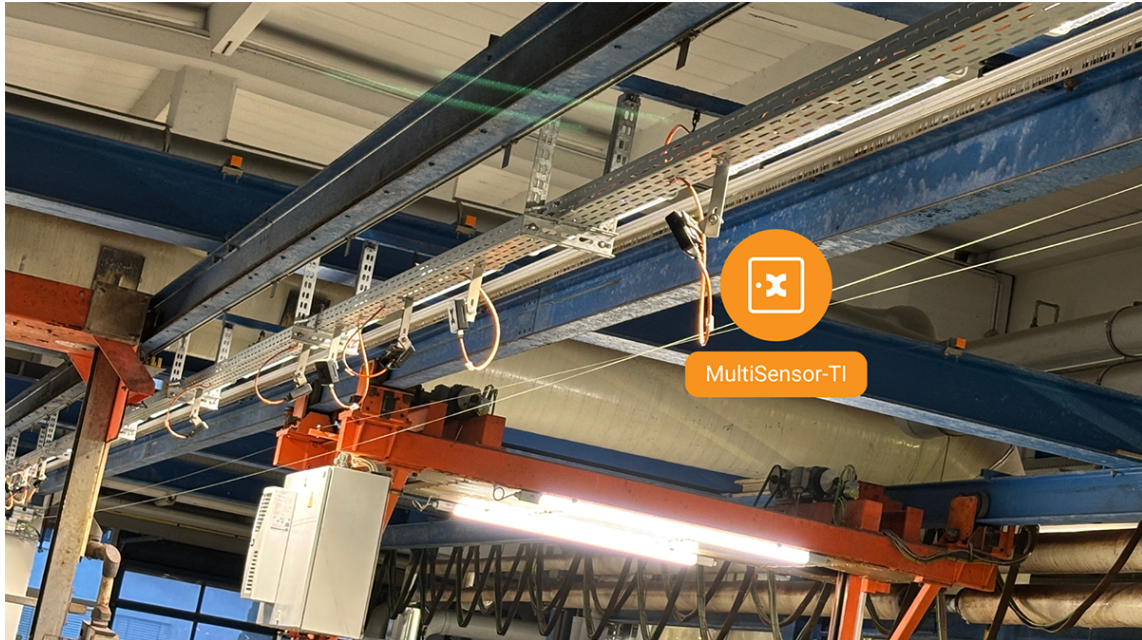
Kentix MultiSensor-TI Überwachung Galvanikbecken
