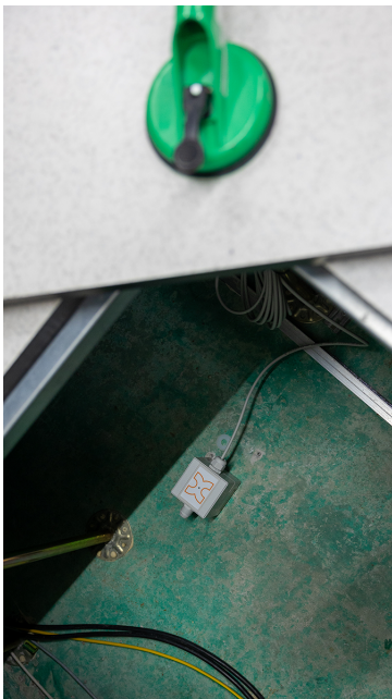
Kentix Leckagesensor im Doppelboden
