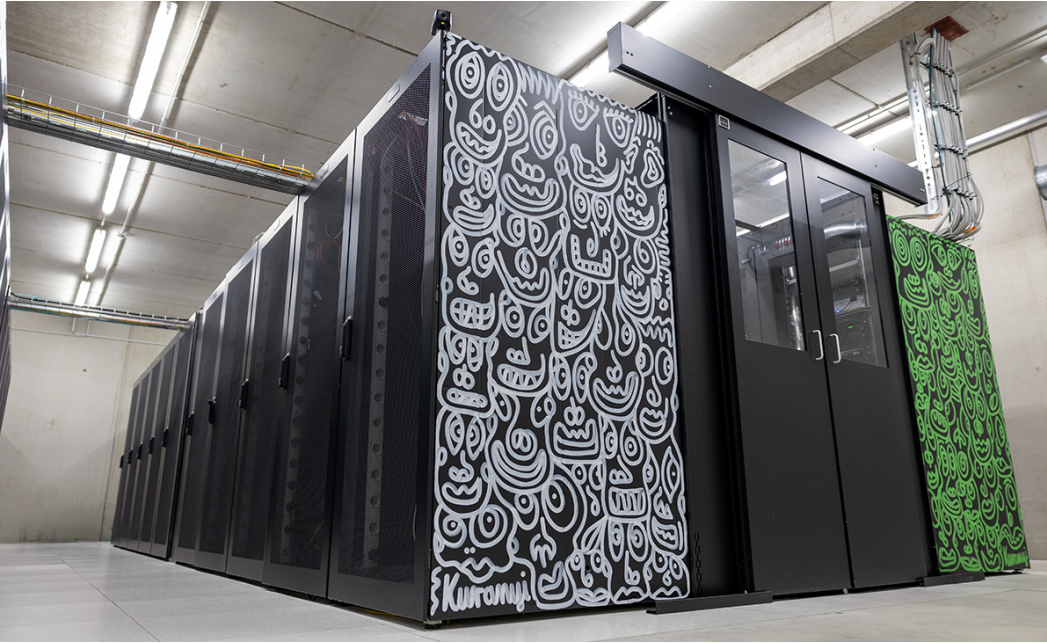
Kaltgangeinhausung mit lückenloser Überwachung über Kentix MultiSensoren und SmartPDU
