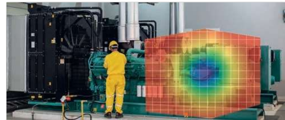
Generatoren, Aggregate, Elektroanlagen
