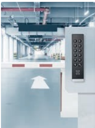
Montage an Schrankenanlagen
