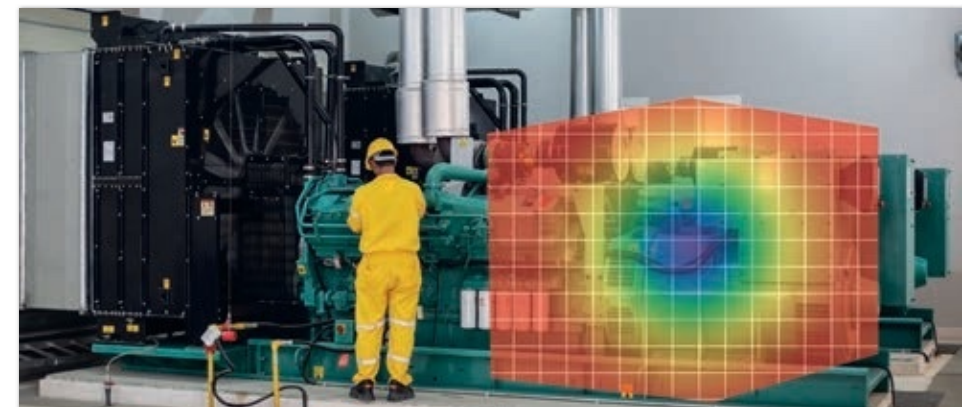
Generatoren, Aggregate, Elektroanlagen
