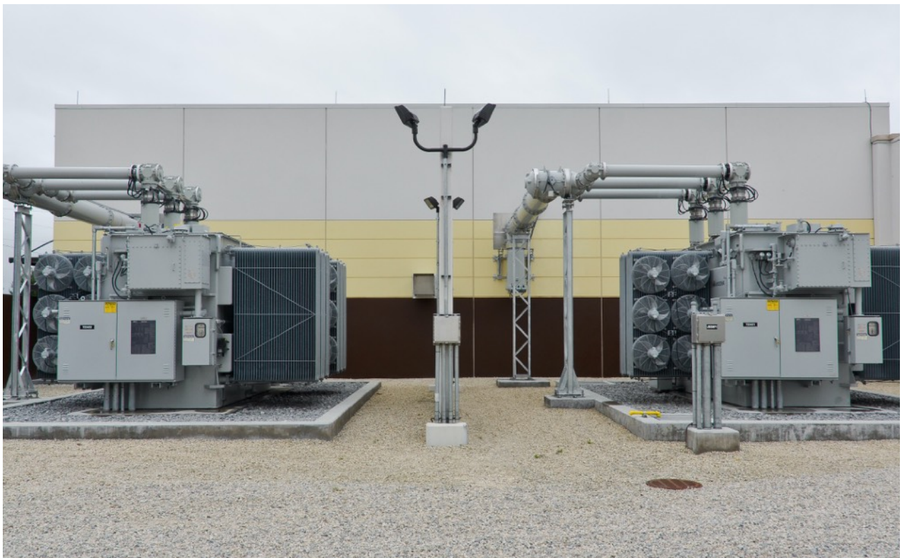
Kritische Infrastrukturen können effizient und effektiv vor Einbruch, unberechtigtem Zutritt, Brand, unerwünschten Umgebungsbedingungen uvm. geschützt werden. Foto: Kentix
